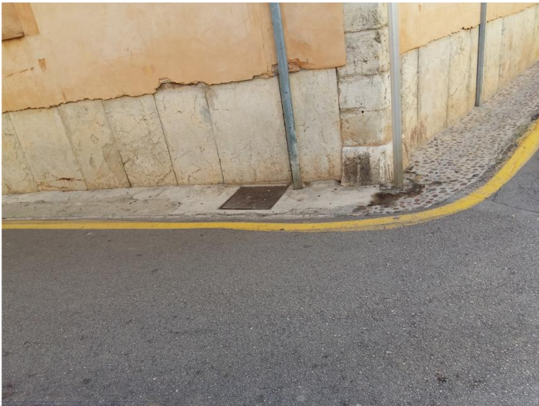
Foto 12: Vista arqueta M Telefónica en intersección c/ Xalet
