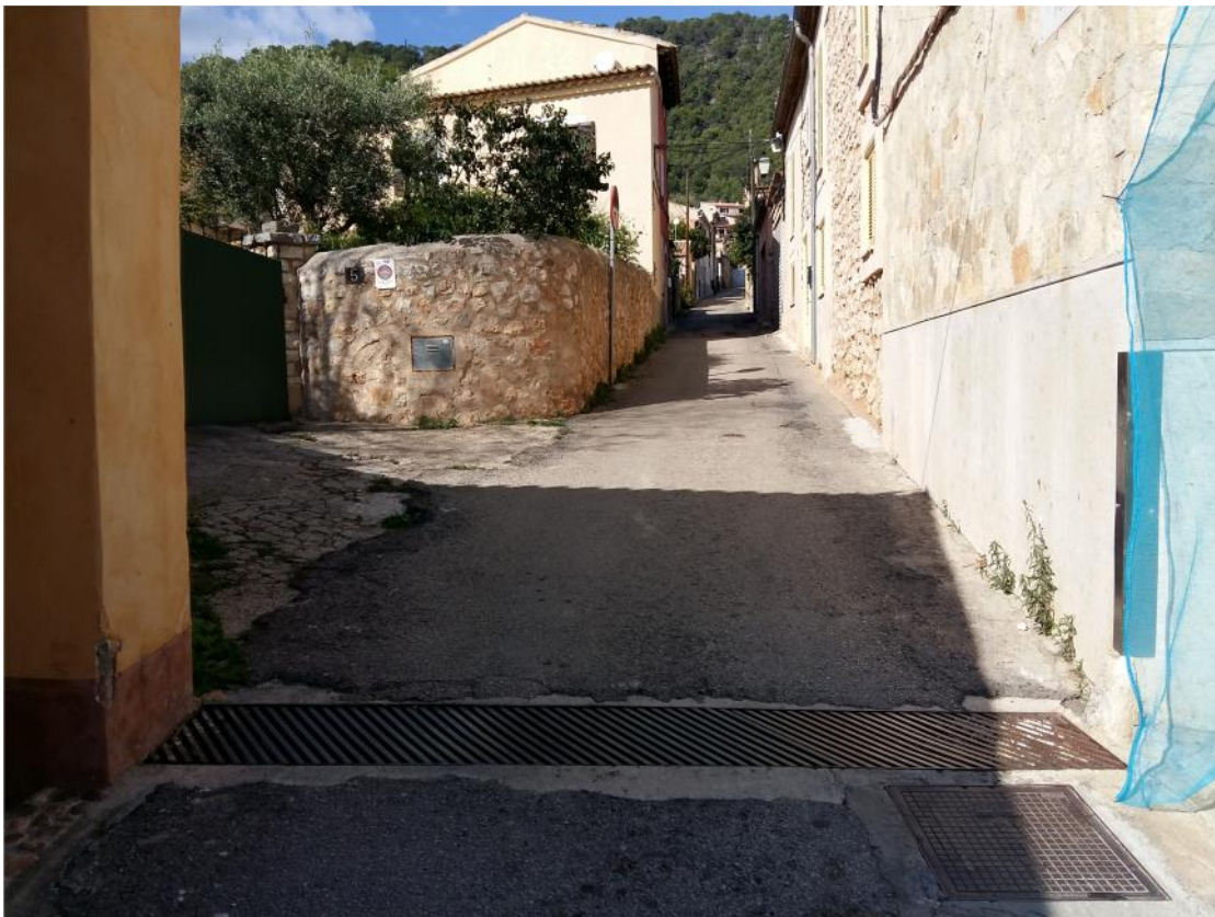
Foto 12: Vista reja a sustituir en calle Sa Comuna des Puig
